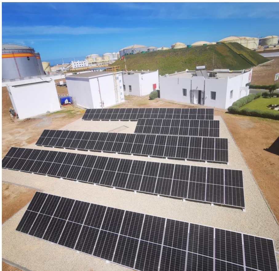
Solarisation du dépôt de Lasfargaz au Maroc (40,4 kWc).
